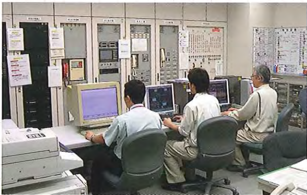
24時間体制で設備を管理している防災センター
